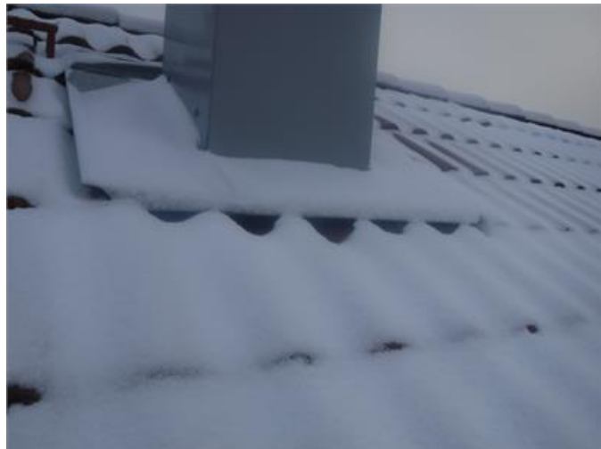
Tak: Det noterades att det inte finns tätning under plåthuven till skorstenen.
