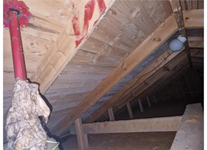
Spår av fukt och mikrobiell påväxt på underlagstaket
