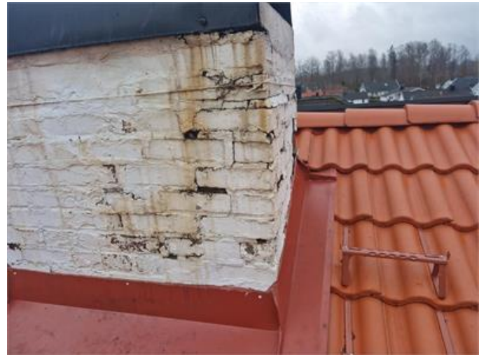
Skorsten med renoveringsbehov
