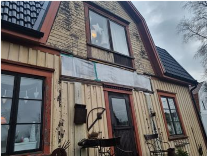
Målnings/underhållsbehov fasad samt del av fasad som är tillfälligt täckt med vindduk efter demontering av balkong.
