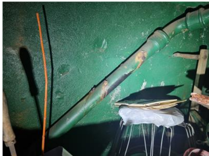
Exempelbild, rostangrepp avloppsrör.
