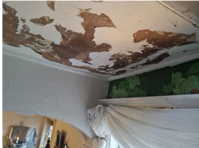
Exempelbild, skada innertak.
