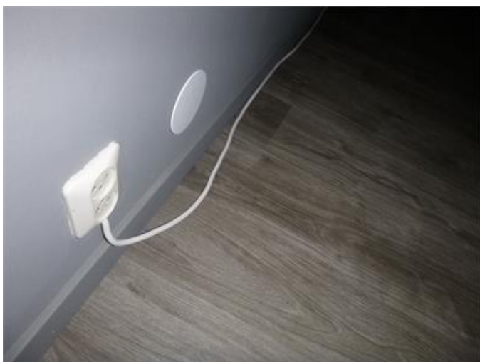
Bilden visar exempel på brister i byggnadens elsystem.
