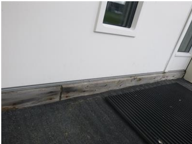
Bilden visar entrédörr där tröskelplåt inte finns.
