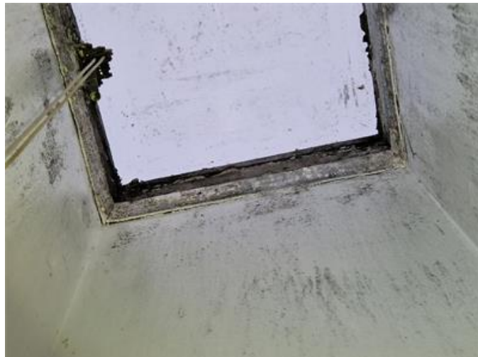
Badrum/Wc: Takfönster är i behov av åtgärder/underhåll.
