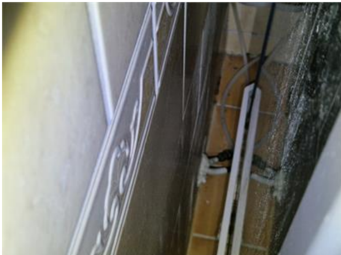
Badrum/Wc: Röranslutningar mot vägg bristfälliga.
