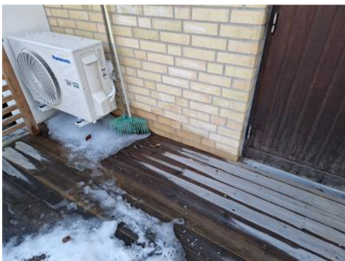
Fasad och Sockel: Fuktuppsug noterades på fasad/Sockel
