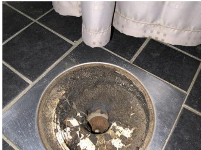
Golvbrunn i badrum LGH 1.
