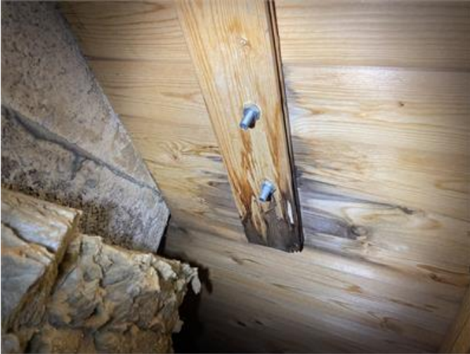
Bild visar läckage i yttertak.
