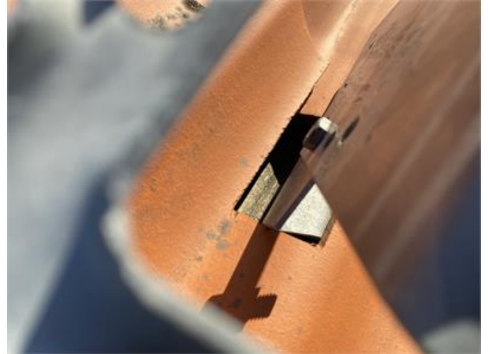
Bild visar otäthet i yttertak vid takbryggans infästning.
