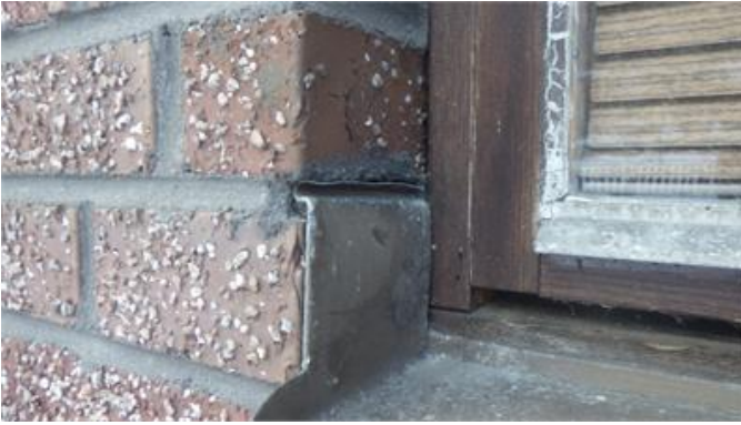
Otät infästning av fönsterbleck
