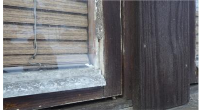
Fönster med målning/underhållsbehov
