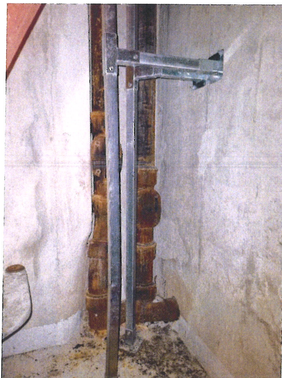
Rostangripna ledningar i källare.
