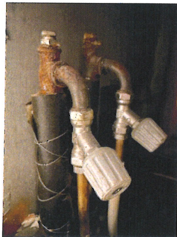
Automatisk luftning har korrosionsskador.
