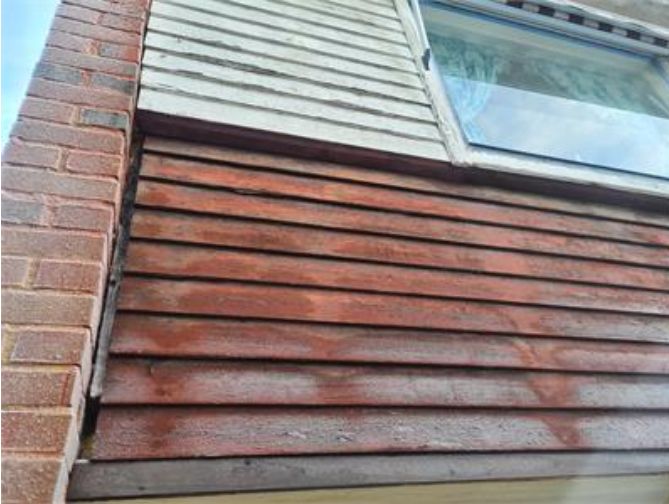
Fasad Trä och Fönster, behov av underhåll alt byte.
