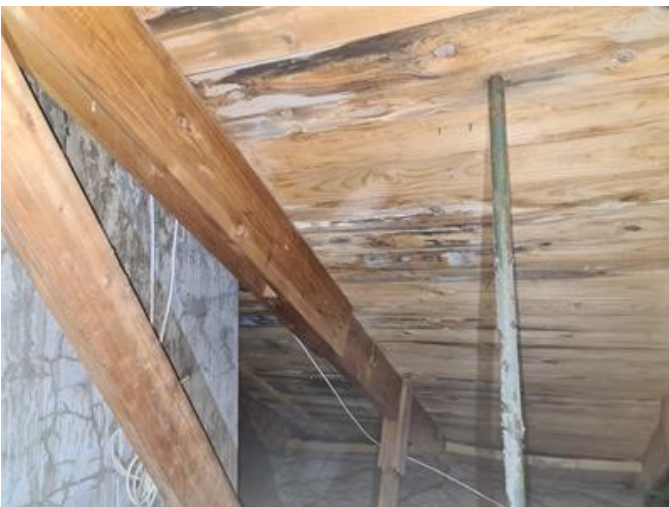
Nockvind, fuktgenomslag i underlagstaket i närheten av murstock.
