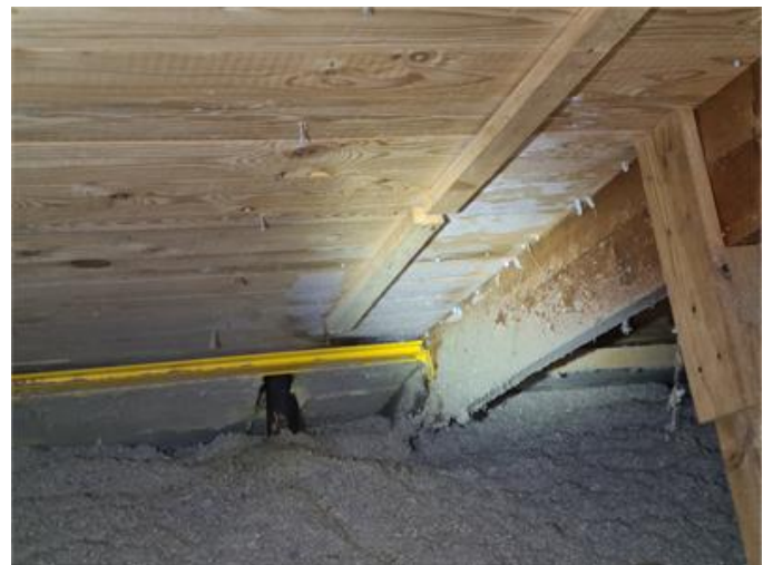
Nockvind, mikrobiell påväxt och kondens (frost) ner mot takfoten ovan Dusch/WC.
