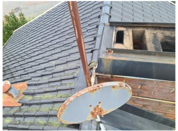
Tak, rostangripna plåtarbeten samt avsaknad av väderskydd ovan skorsten.
