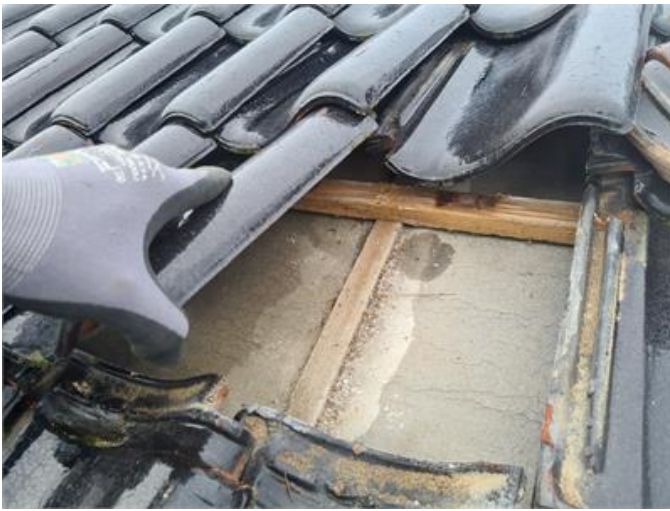
Tak, äldre med torr underlagspapp med sprickor.
