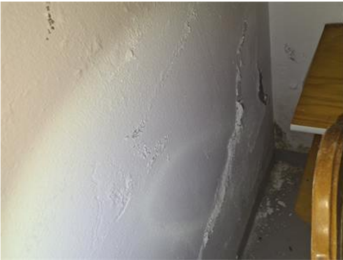
Sutterängkällare, färgsläpp och mineralutfällningar på insidan av grundmur
