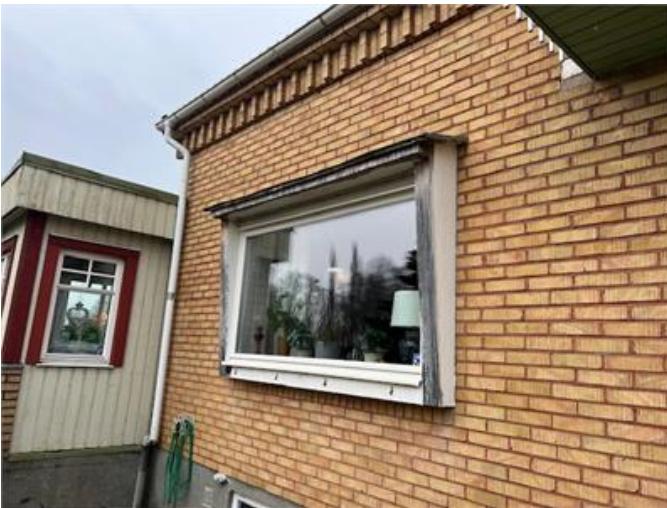
Pos 3. Trädetaljer runt ett fönster har underhållsbehov.
