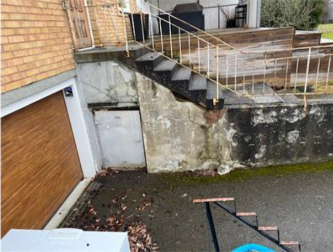
Pos 1. Sprickor och betongsläpp förekommer i trappor.
