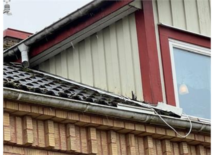
Pos 2. Lokal rötskada noterades vid takkupa
