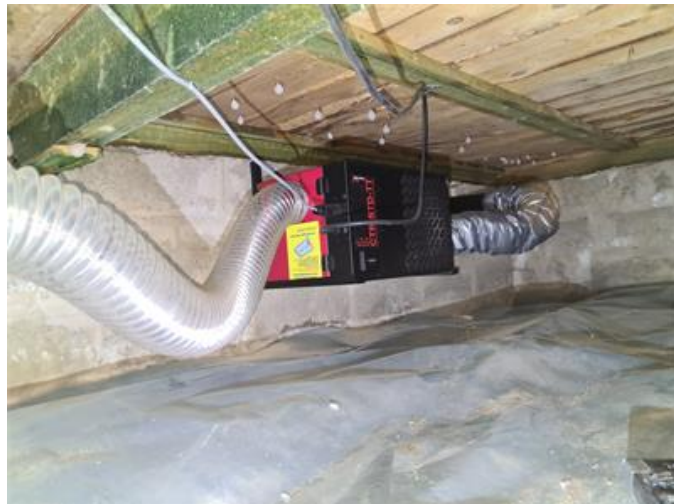
Krypgrundsavfuktare finns installerad.
