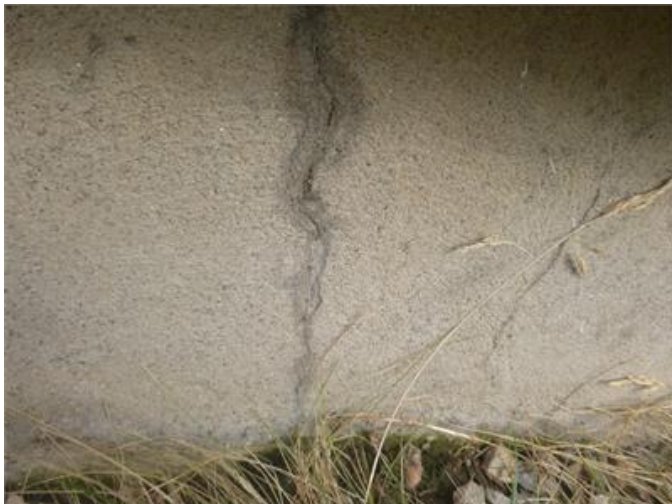
Bilden visar exempel på spricka i sockeln/grundmuren.
