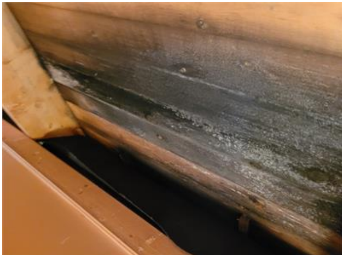
Läckage i yttertak
