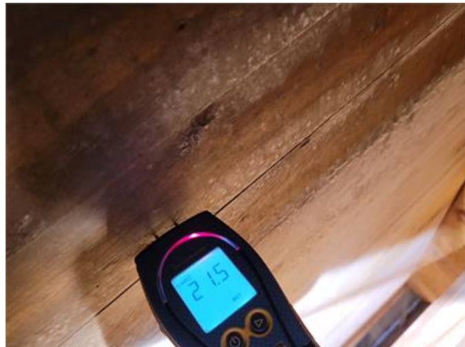
Mikrobiell påväxt på underlagstak
