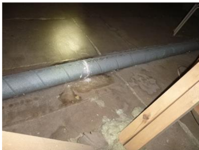
Bilden visar exempel på missfärgningar vid ventilationsrör.
