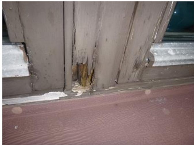
Bilden visar exempel på rötskador i fönster.
