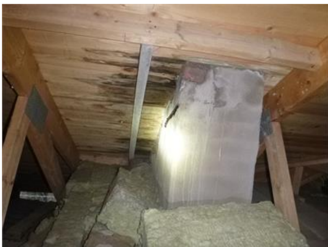
Bilden visar exempel på missfärgningar vid skorstenen.
