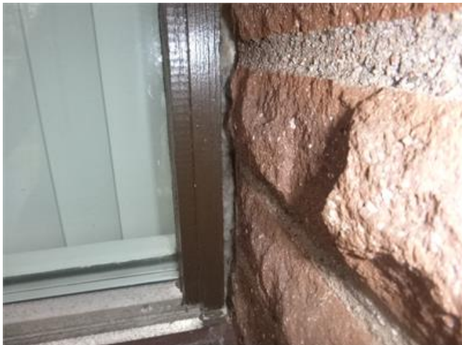
Bilden visar exempel på otätheter/brister vid fönster.
