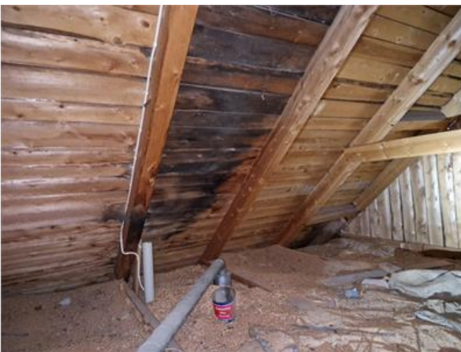
Vind avloppsluftning är öppen. Vakuumentil bör monteras.
