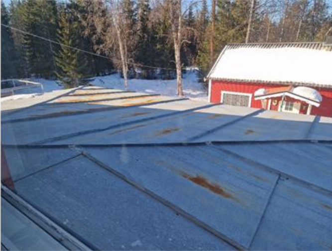
Tak, begynnande rost noteras på delar.
