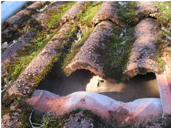
Yttertak på hus 58, mossa på pannor samt tunn och spröd underlagspapp
