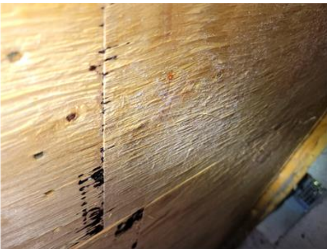
Mikrobiell påväxt på blindbotten (Krypgrund)
