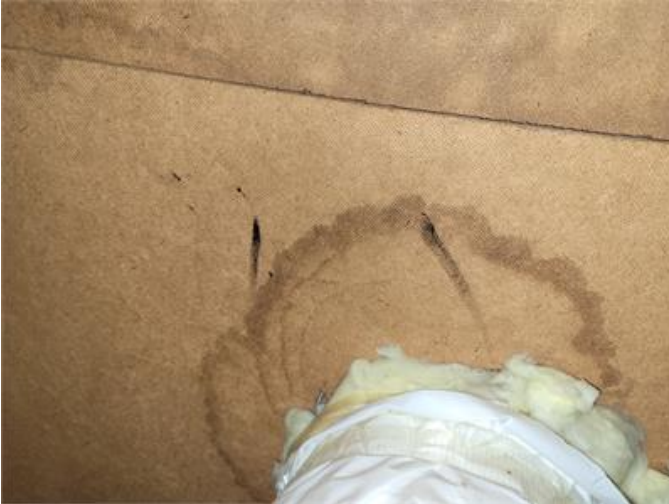
Fuktfläck på underlagstak (Vinden)
