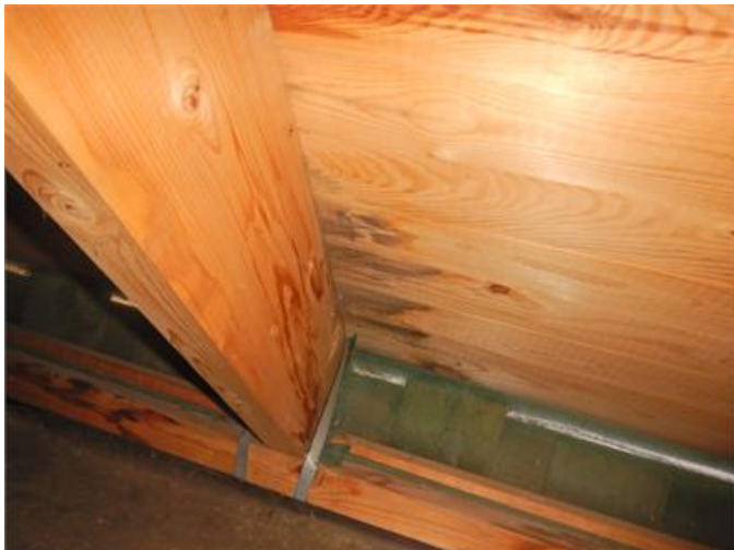
Missfärgning o mindre omfattning på yttertaketets insida.
