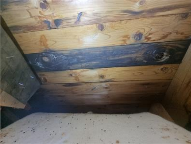
Exempelbild, fuktfläck underlagstak. Vy från sidovind.
