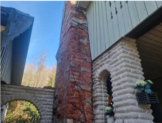
Frysskador "utvändig" murstock och fuktpåverkan på intilliggande kalksandstensfasad.
