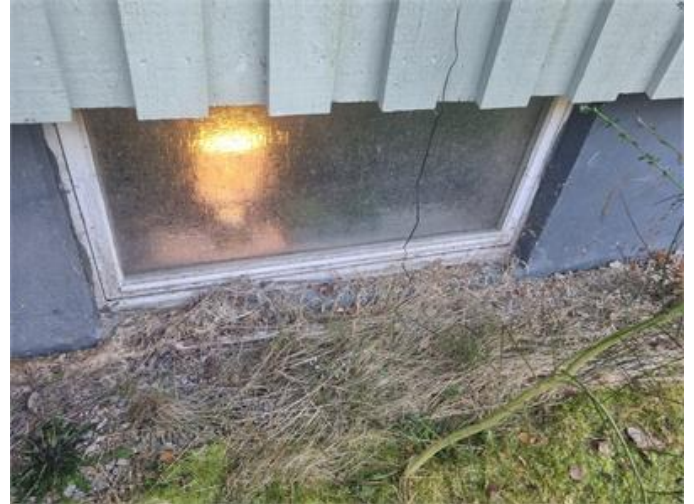
Äldre fönster i behov av målning/underhåll.
