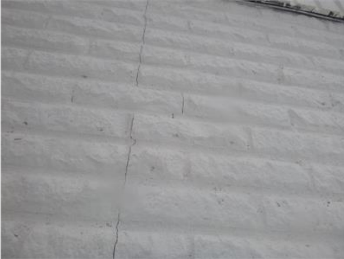
Bilden visar exempel på spricka i stenfasaden.
