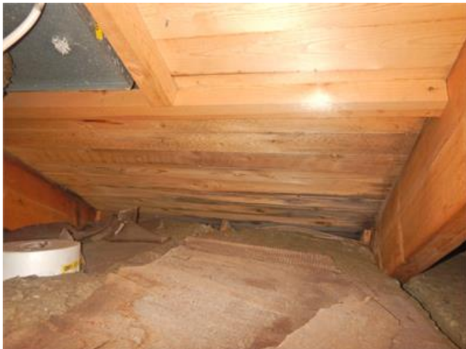
Missfärgning på vind efter tidigare fuktpåverkan.
