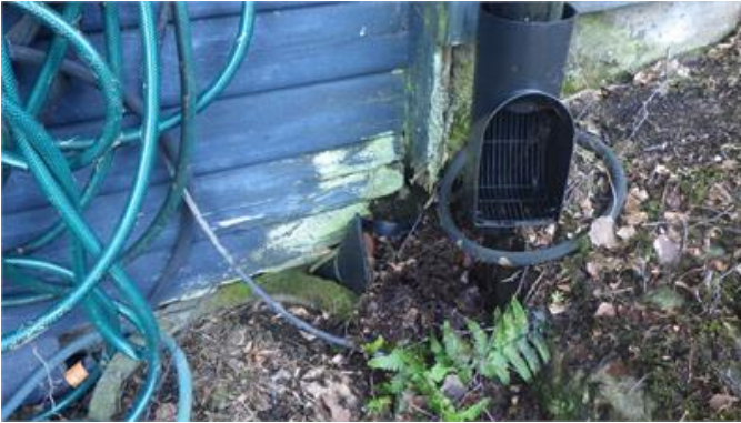
Rötskada i fasadpanelen och bakomliggande konstruktion
