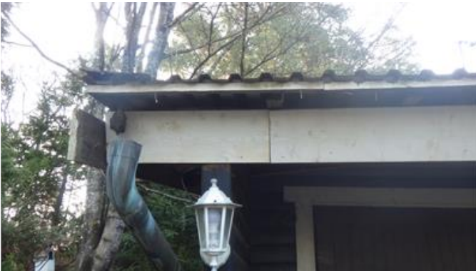
Stuprör som inte är kopplat och avsaknad av hängränna
