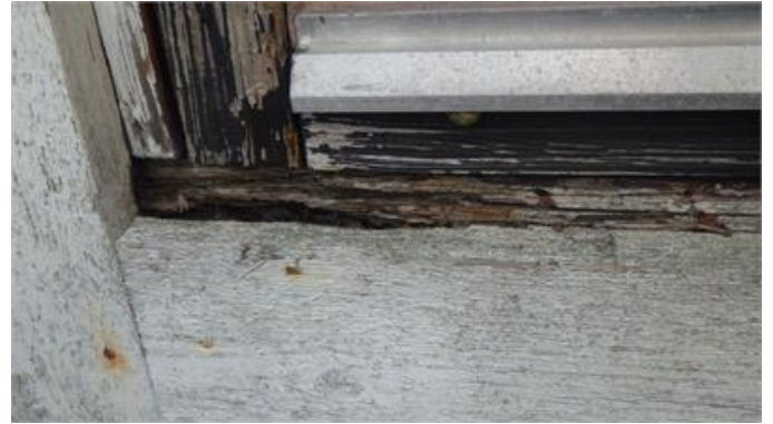
Rötskada i fönster
