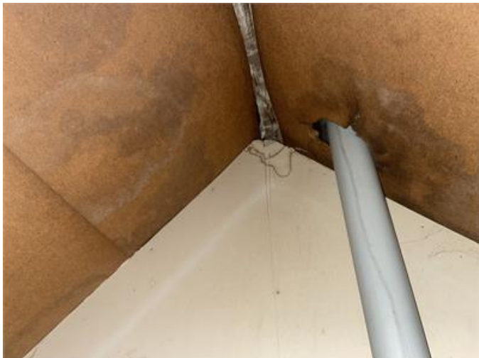
Fuktmärke i takboard
