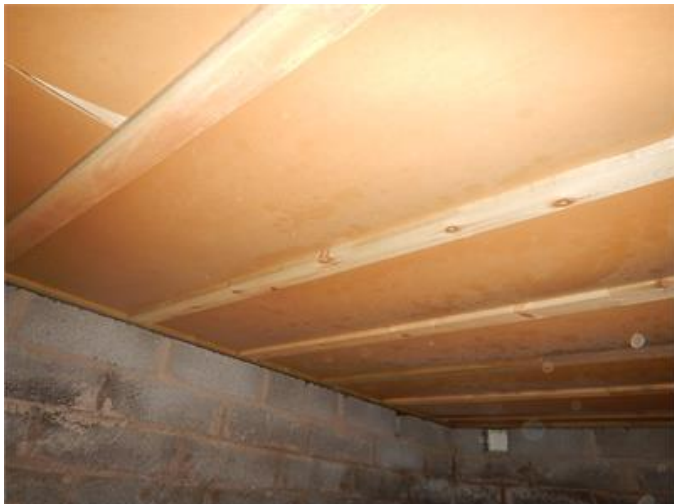
Mikrobiell påväxt på blindbotten krypgrund.
