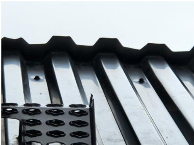
Tak trapphus: Nockplåt saknas. Se bild
