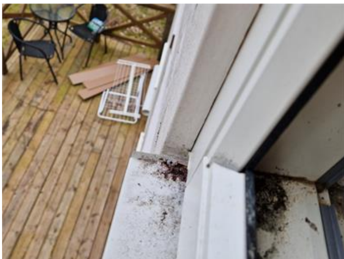
Fönster: Uppvik på fönsterbleck är något korta
