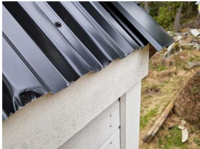
Tak trapphus: Överhäng mot takfot anses ej tillräckligt, Hängrännor/Stuprör saknas
