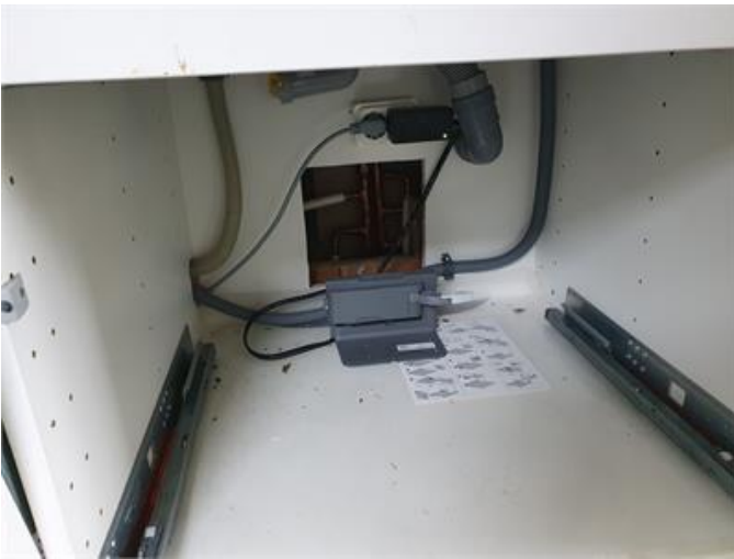
Inbyggda spolhus utan tätskikt och rörkopplingar i vägg
