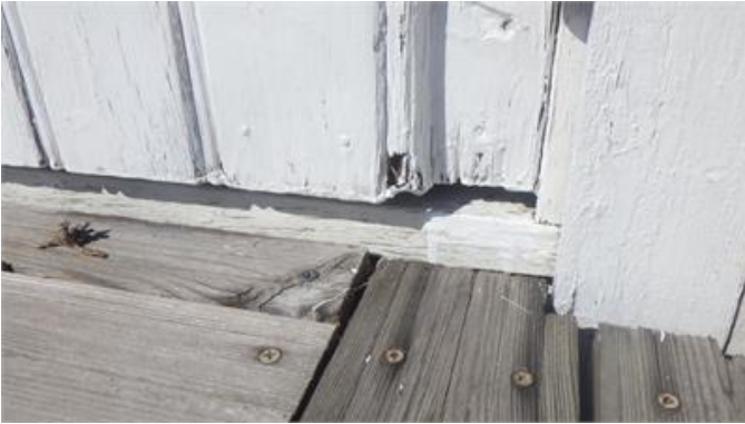
Rötskada i altandörr
