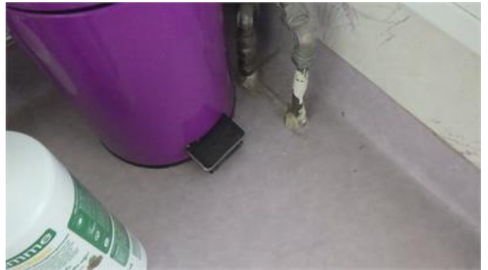
Rör genomföring i våtrumsgolv
