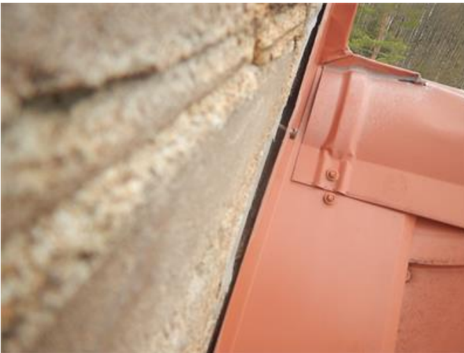
Otätthet mellan murstock och skorstensbeslag.
