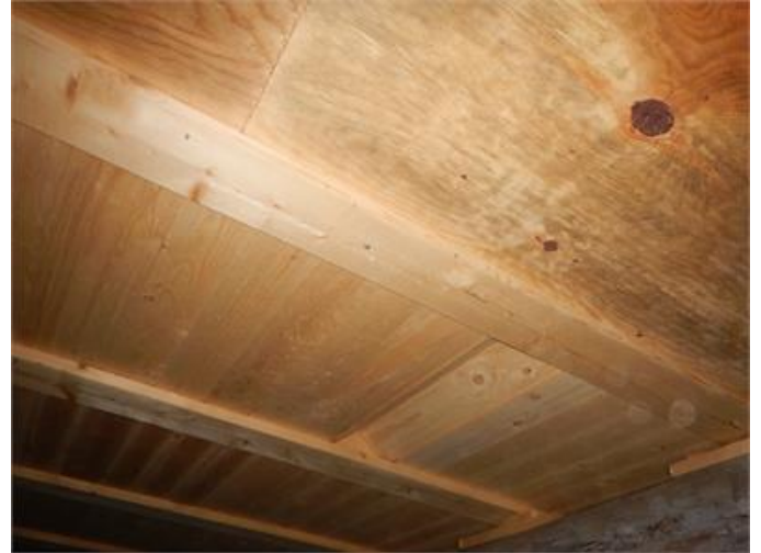
Mikrobiell påväxt och formförändring blindbotten krypgrund.
