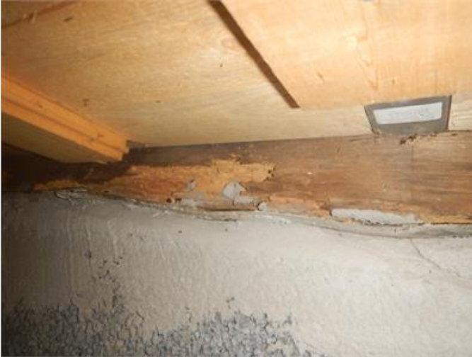
Insektsangrepp i syllstock krypgrund.
