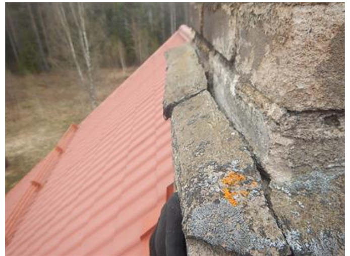
Stenar/murbruk löst på murstock
