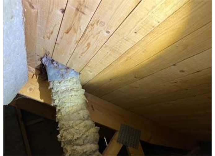
Pos 2. Fuktfläckar förekommer på underlagstak.
