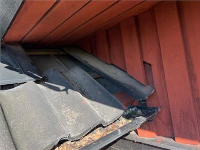
Pos 1. Takpannor saknas lokalt under takfot vid entrén.
