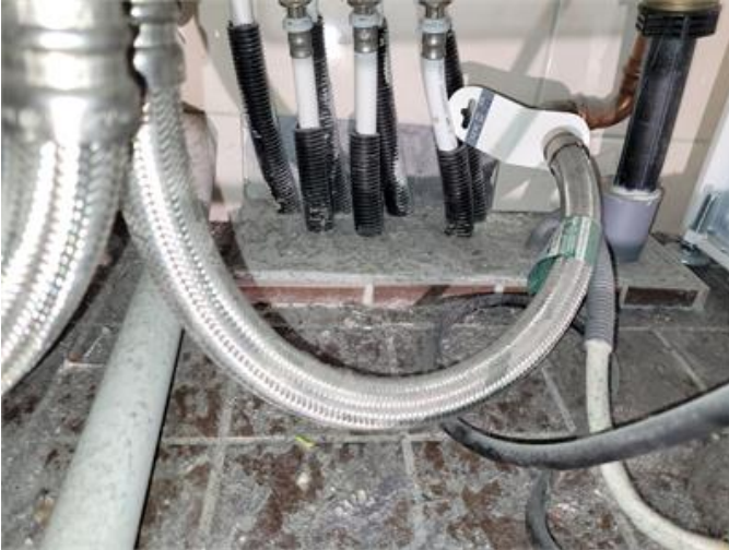
Rör genomföringar i golvklack
