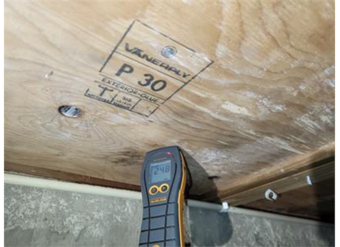
Mikrobiell påväxt samt hög fuktkvot på blindbotten
