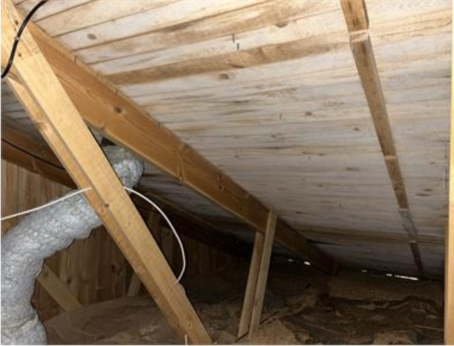
Mikrobiell påväxt på vinden
