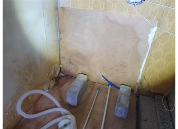
Garage: Fuktfläckar och formförändringar förekommer på innerväggar och i innertak
