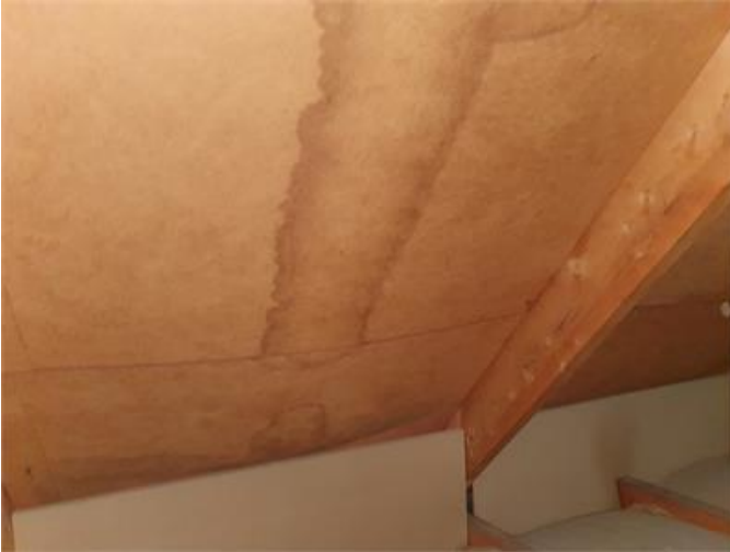
Sidovindar: Fuktfläckar förekommer på masonitskivor i underlagstak.
