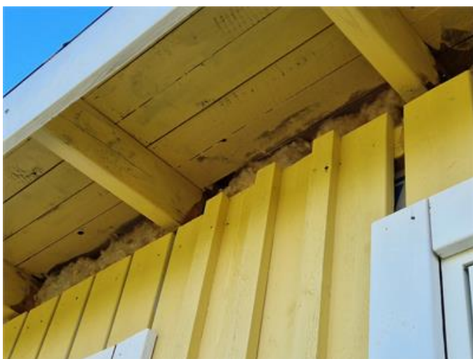
Tak: Öppen isolering noterades i takfot under låglutande tak
