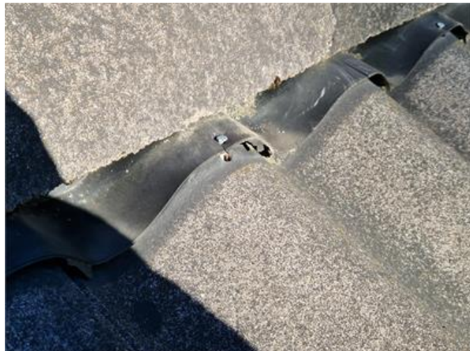
Tak: Nockpannor täcker inte spikhål på övre pannraden
