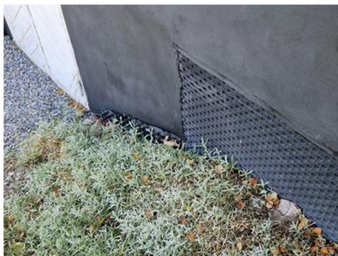
Socket: Utvändigt fuktskydd synligt ovan mark.
