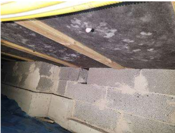
Mikrobiell påväxt på blindbotten
