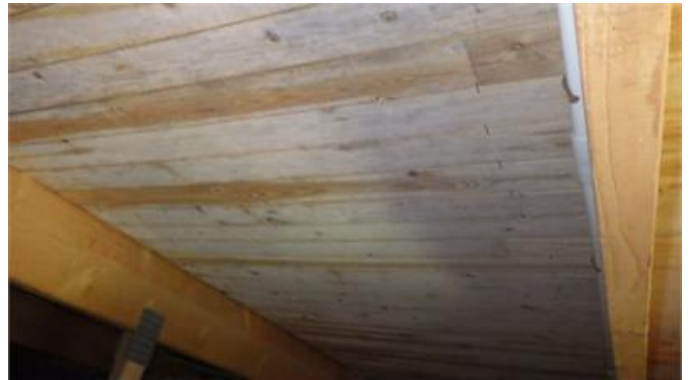
Mikrobiell påväxt på vinden
