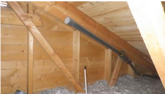
Rör från centraldammsugaren som avslutas på vinden
