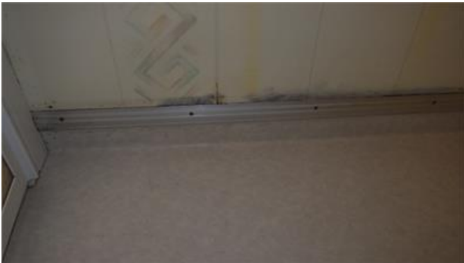
Missfärgning på nederkant duschvägg
