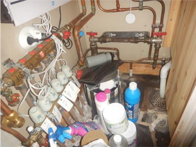
Utrymme där golvvärme fördelare ej är fuktsäkert placerad och läckage uppstått.
