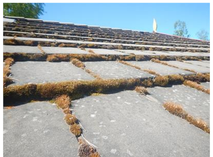
Mossa på takpannor.
