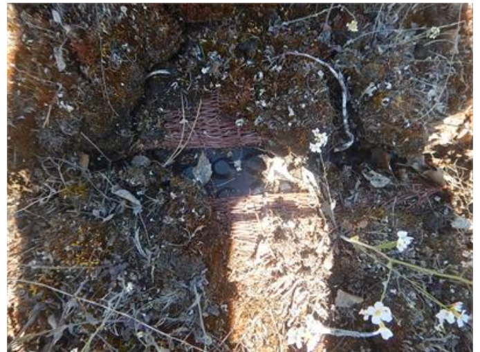
Torvtak som bör kompletteras.
