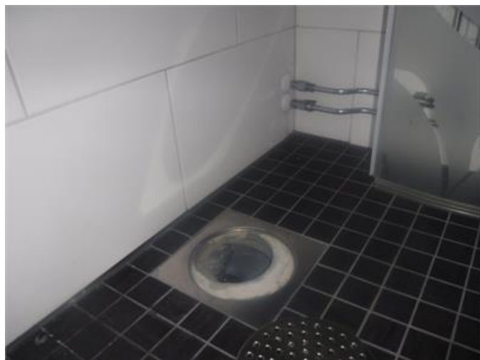
Dusch/Wc - Entréplan: Tätskiktet (fuktskyddet) bakom kakel och klinker går ej att besiktiga. Golvbrunnen är monterad för nära väggen och det finns rörgenomföringar i våtzon vilket inte få förekomma i renoverade våtrum. Bristerna öka risken för fuktskador.
