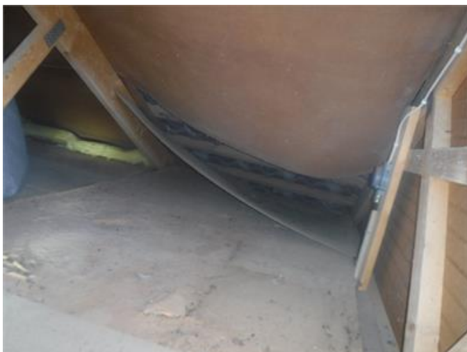
Vind/garage: Ett par undertaksskivor av Masonit har lossnat och det rekommenderas åtgärdas.
