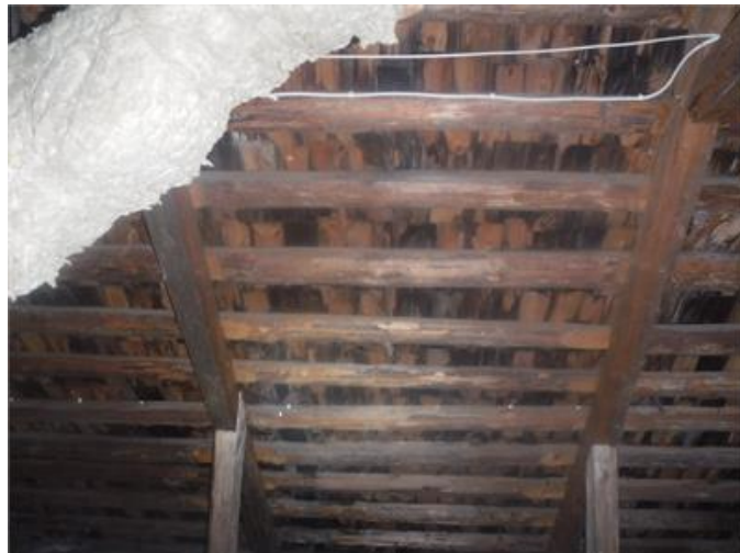
Vind/bostadshuset: Det finns skador/hål på det äldre undertaket av träspånor som enligt bedömning främst är äldre skador.
