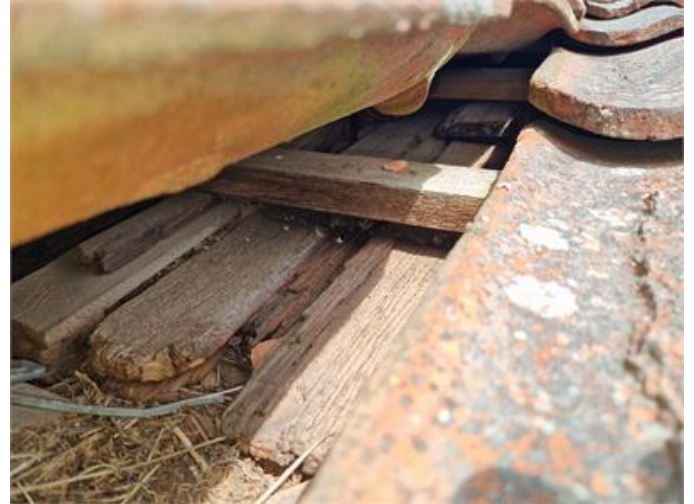
Underlagstak av sågad takspån.
