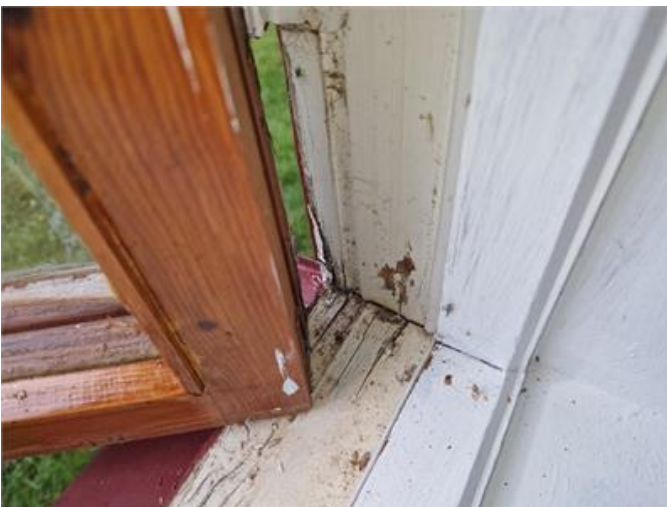
Vissa fönster och fönsterkarmar är i behov av underhåll
