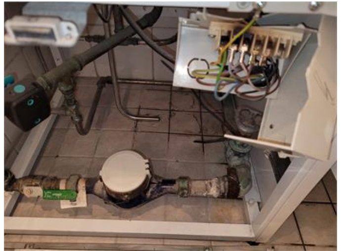
Ärg på rör samt trasig kopplingsdosa
