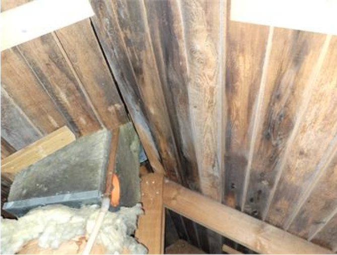
Mikrobiell påväxt på underlagstak.
