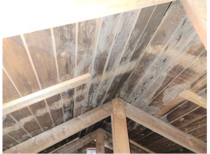
Mikrobiell påväxt på underlagstak.
