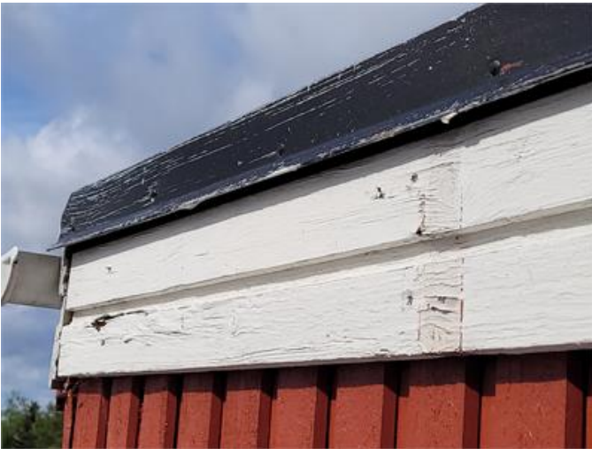
Rötskadad vindskiva på balkongtak.
