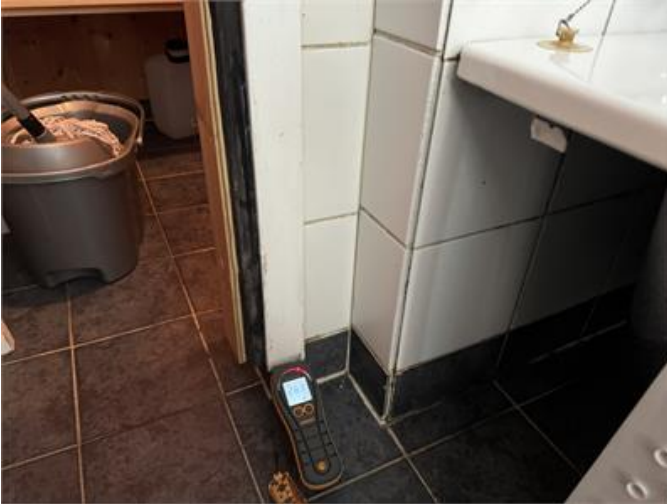
Fukkvotsmätning i foder och översiktsbild av badrum/bastu.
