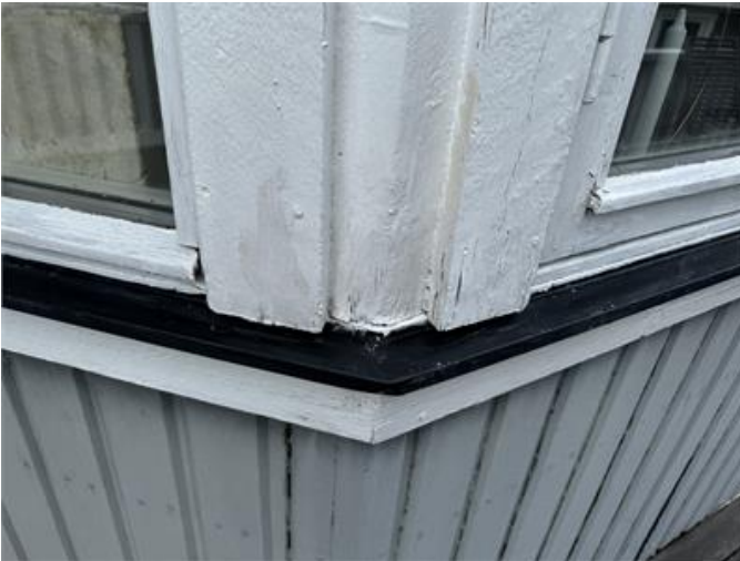
Rötskador i burspråkets konstruktion.
