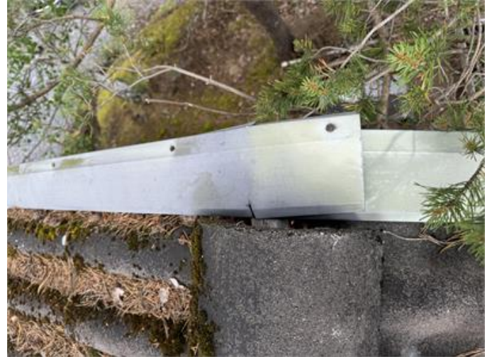
Otätheter mellan vindskiveplåt och nockpanna.
