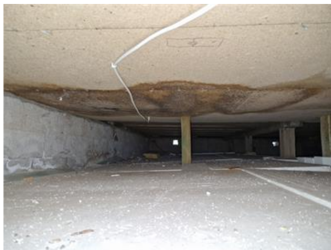
Krypgrund. fuktfläck från tidigare läckage under våtrum 3.
