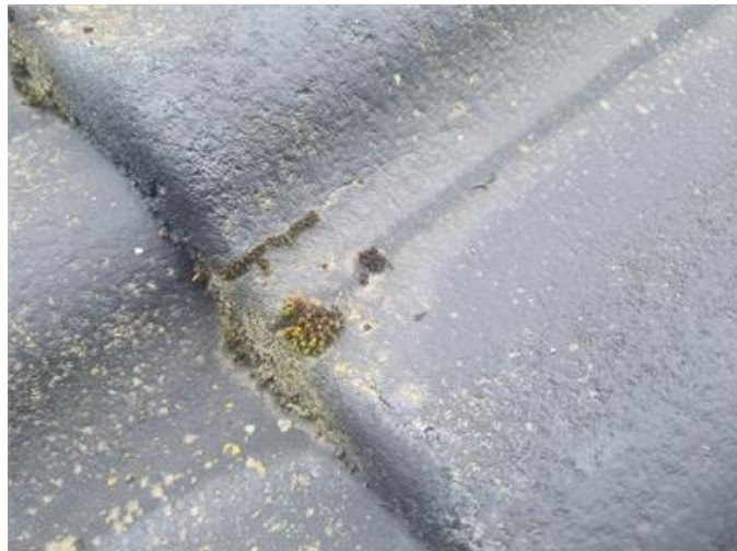
Exempelbild, spricka i takpanna.
