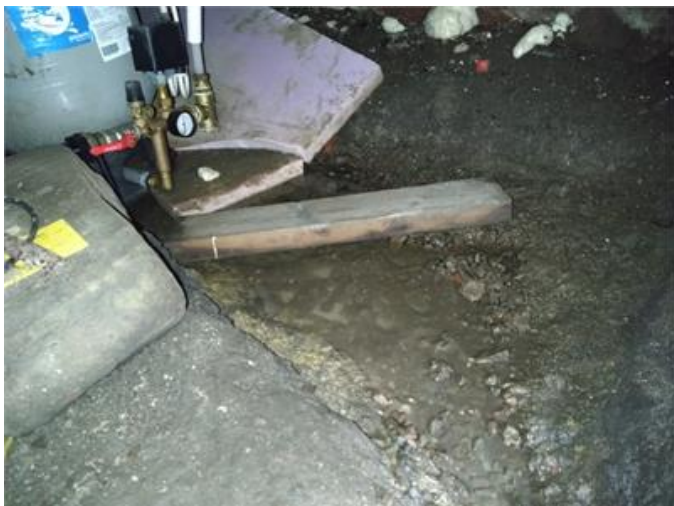
Vatten på mark i grund två
