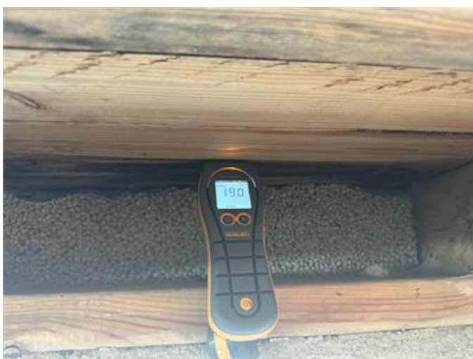
Förhöjda fuktkvotsvärden i förrådets underlagstak.
