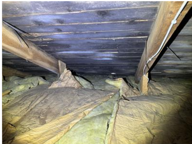
Mikrobiell påväxt på vindens underlagstak.
