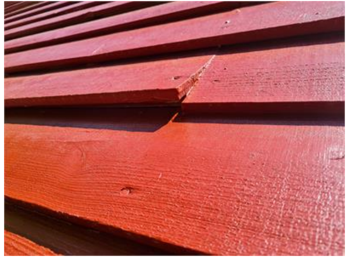
Fasadpanel noteras ha vridit sig och glipor har uppstått.
