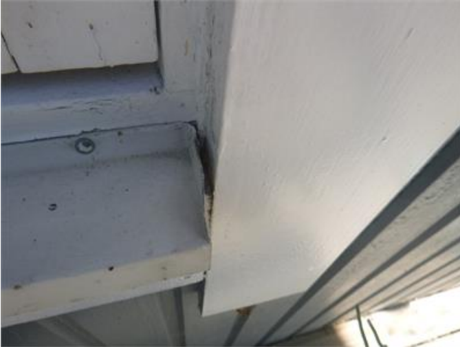
Bilden visar exempel på otätheter vid fönsterplåt.
