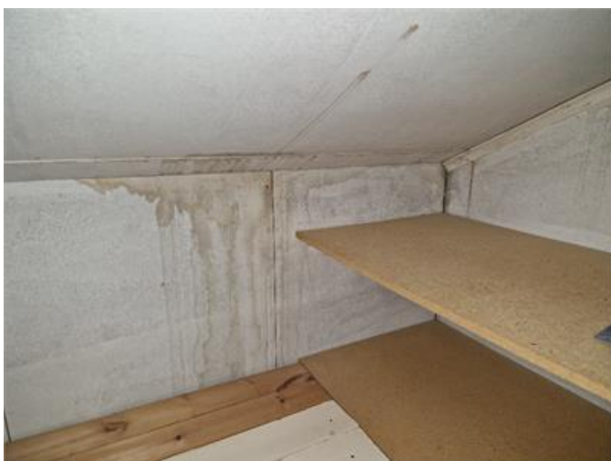
Fuktfläckar noteras allmänt.
