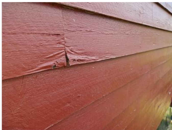
Rötskador noteras i fasadpanel.
