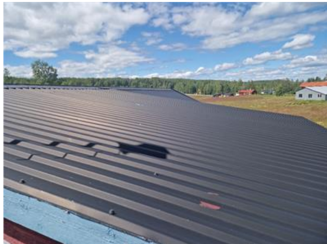
Delar av tak är låglutande.
