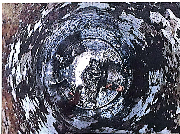
Bild 1: Fördelningsbrunn med tecken på slamflykt
