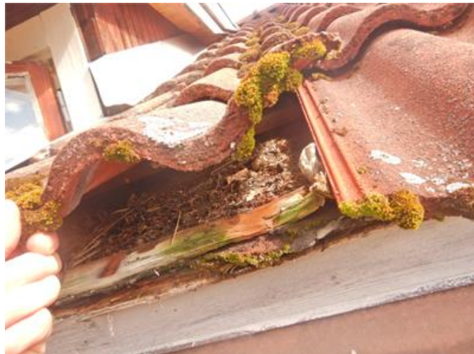
Läkt skadad vid takfot
